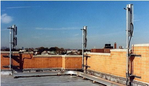
Figura A.a.4: Soporte de pared para tuberías instalado en la pared del parapeto de un edificio
