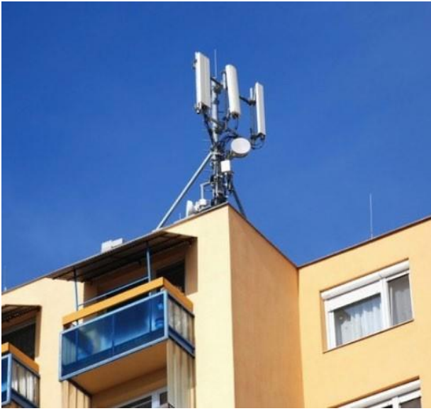
Figura A.d.3: Torre monopolo pequeña instalada en el tejado de un edificio
