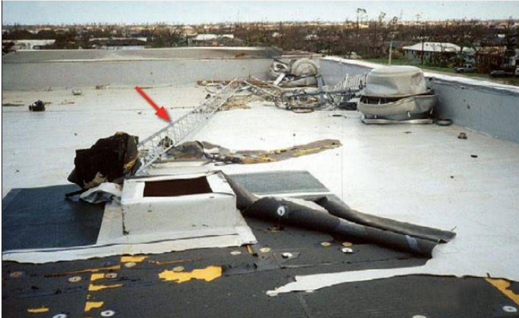
Figura B.5: Colapso de la torre de antena montada en el techo, incluyendo el desprendimiento progresivo de la membrana del techo (Referencia: FEMA 543 Serie de Gestión de Riesgos: Guía de Diseño para Mejorar la Seguridad de las Instalaciones Críticas contra Inundaciones y Vientos Fuertes (Enero de 2007))
