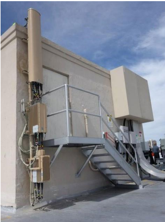
Figura A.a.2: Soporte de pared instalado en la pared del ático de un edificio
