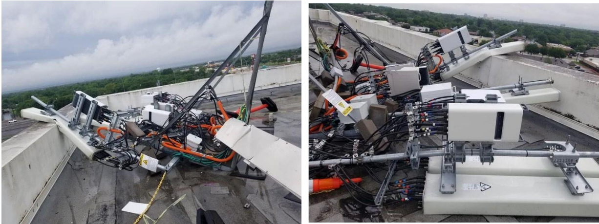
Figura B.1: Marco de montaje de trineo en la azotea volcado por no tener suficientes bloques CMU
