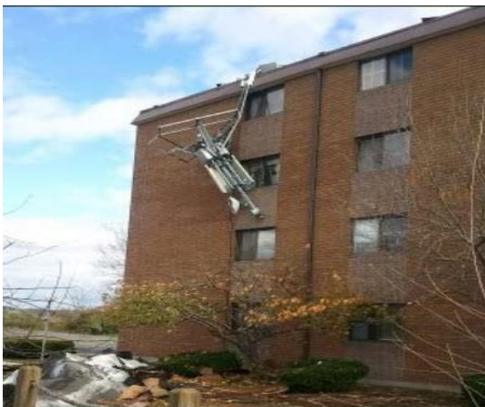
Figura B.3: El soporte de trípode en la azotea se cayó del techo por no tener suficientes bloques CMU o un anclaje adecuado
