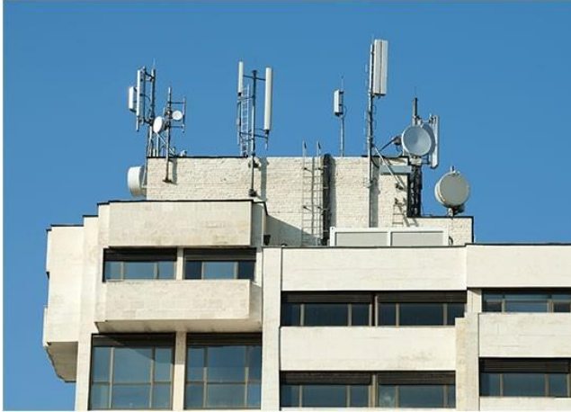
Figura A.a.3: Diferentes tipos de soportes de pared instalados en la pared del ático de un edificio
