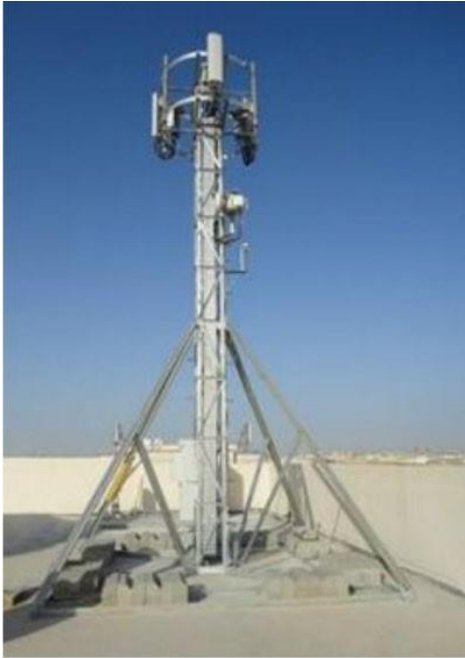
Figura A.d.1: Torre de celosía pequeña lastrada en la esquina del techo de un edificio
