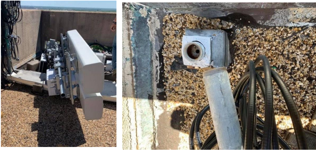
Figura B.4: Fallo del montaje de la antena del panel de parapeto debido a un anclaje incorrecto
