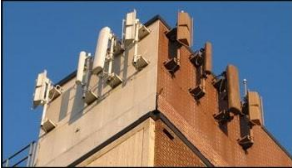
Figura A.a.1: Soporte de pared instalado en el exterior del edificio
