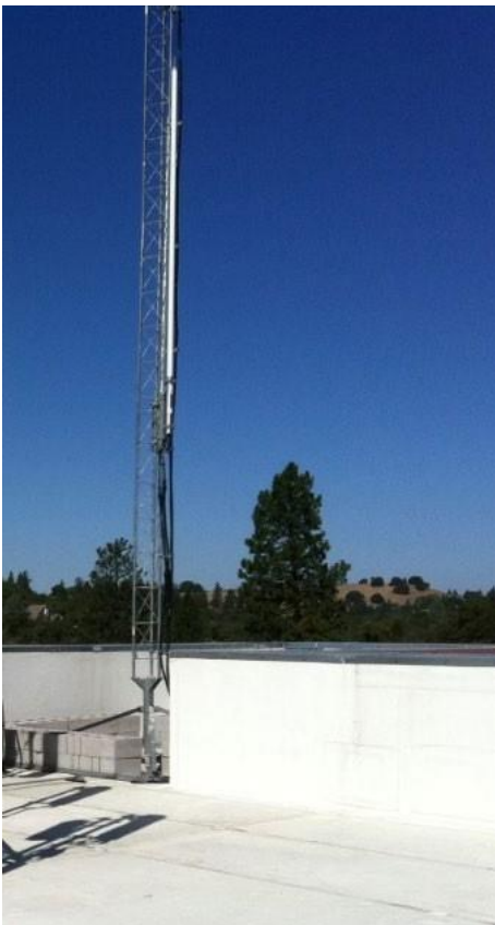
Figura A.d.2: Torre de celosía pequeña lastrada en la esquina del techo de un edificio
